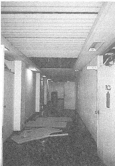
廊下の天井破損（1号館4階）
