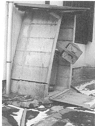
ボンベ置場の破損（六甲山セミナーハウス）
