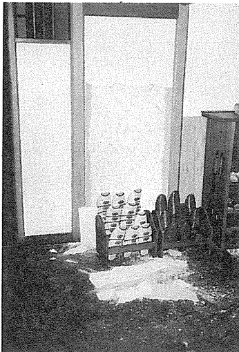
内壁の剝離落下（六甲山セミナーハウス）
